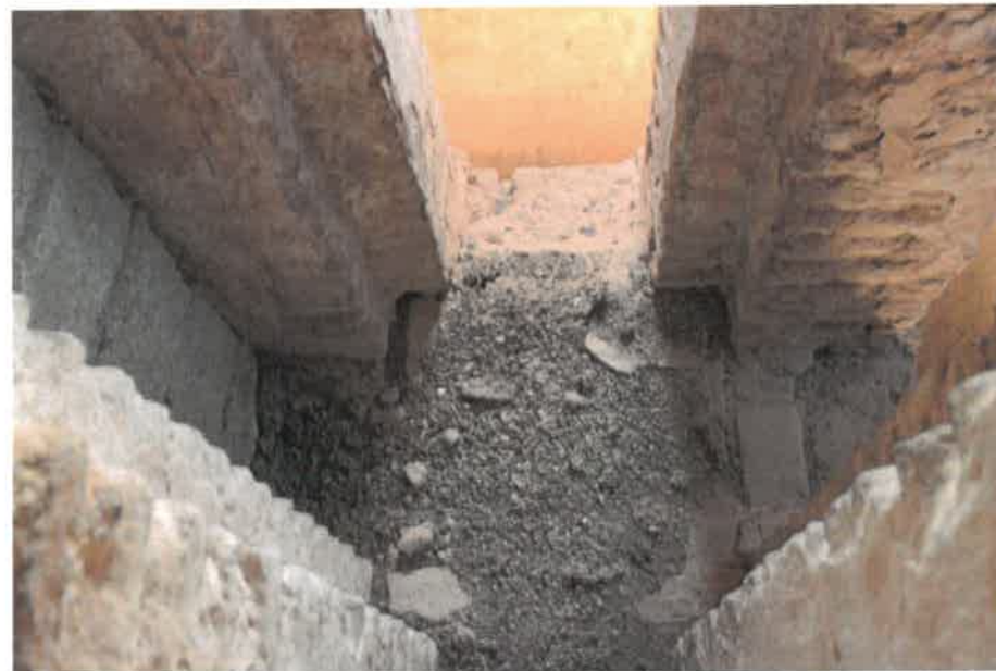
PH 73: Détérioration d'Azri
