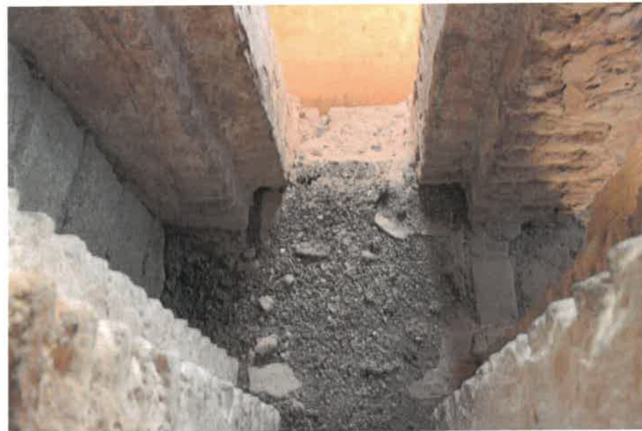
PH 73: Détérioration d'Azri
